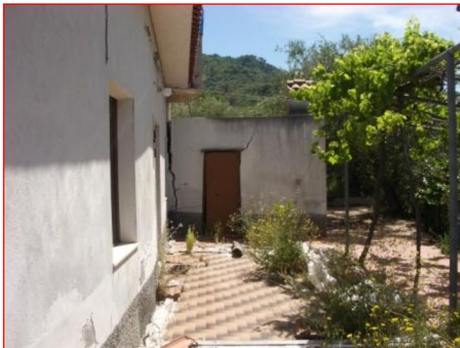
Località Due Fiumare – Dissesto 016I-5NA-049 (fabbricati in dissesto)
