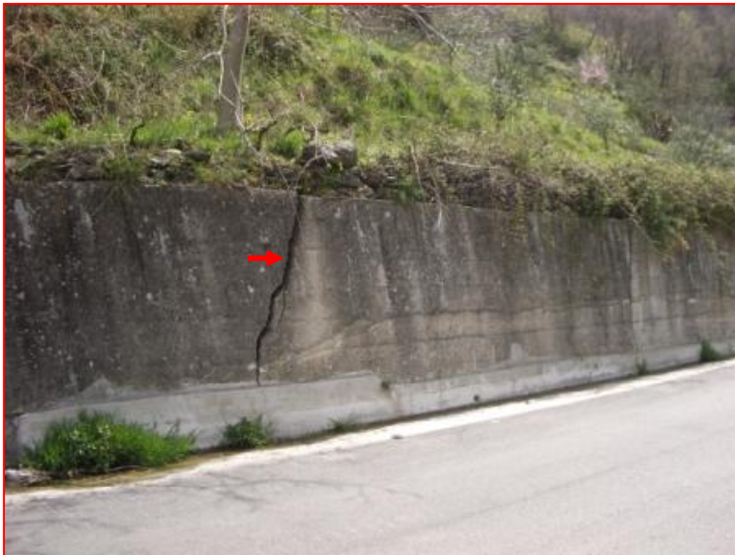
Località Bolo-San Basilio – Dissesto 016I-5GM-123. Area a franosità diffusa
