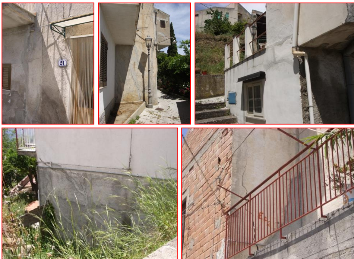
Località Malò Est – Dissesto 016I-5NA-046 (evidenti dissesti nei fabbricati)
