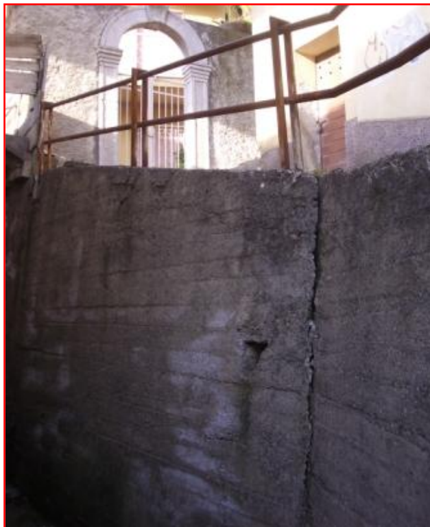
Centro abitato – Dissesto 016I-5GM-201. Fratture nei fabbricati e nei muri
