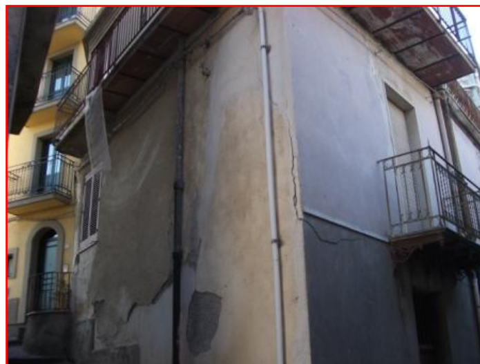
Centro abitato – Dissesto 016I-5GM-201. Fratture nelle strutture interne ed esterne
