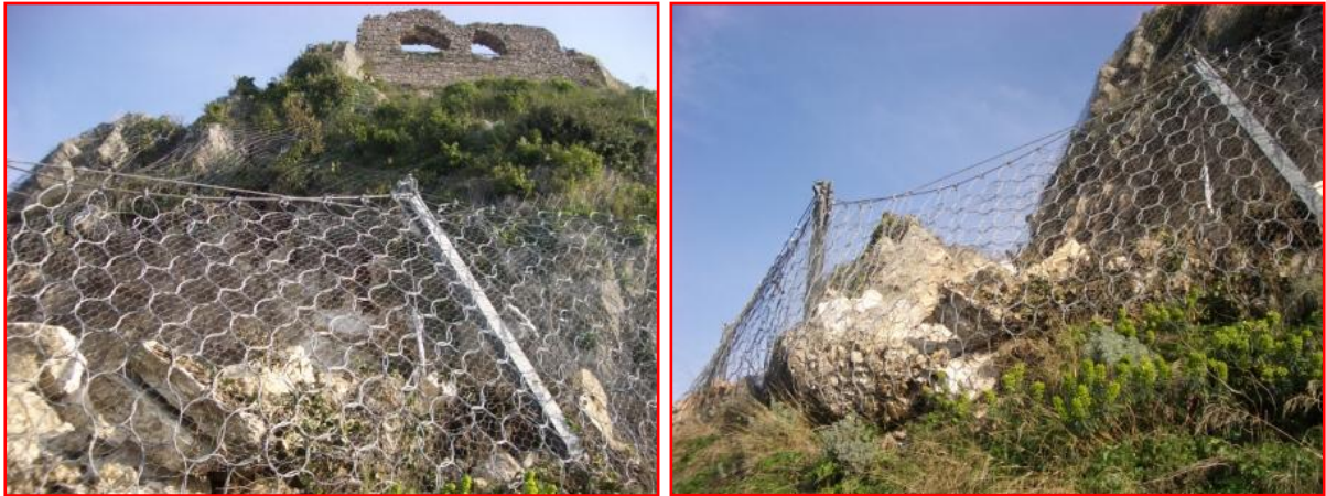
Località Sotto Castello – Dissesto 016I-5GM-170. Crolli di massi lapidei di notevoli dimensioni dal costone roccioso, bloccati dalla rete paramassi
