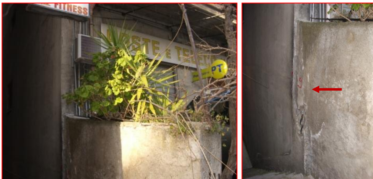
Centro abitato – Dissesto 016I-5GM-201. Fratture nei fabbricati e nei muri
