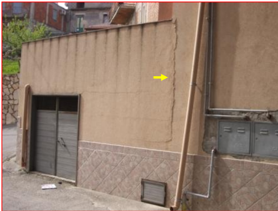
Centro abitato – Dissesto 016I-5GM-166. Fabbricati in dissesto (Sant'Antonino – traverse via Alessandro Manzoni)
