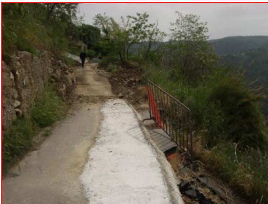
Località Terrano – Strada comunale all'interno del dissesto 014-5NA-023
