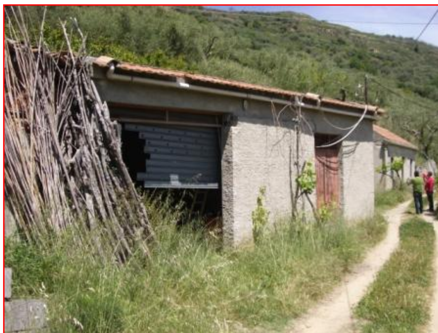
Località Rumbiale – Dissesto 016I-5NA-048 (fabbricati coinvolti)
