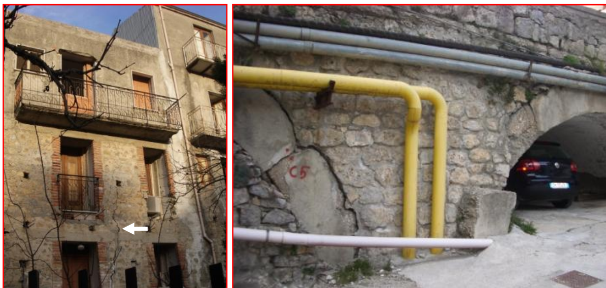
Centro abitato – Dissesto 016I-5GM-201. Fratture nei fabbricati e nei muri (Ponte via Cavour, angolo via Industriale)
