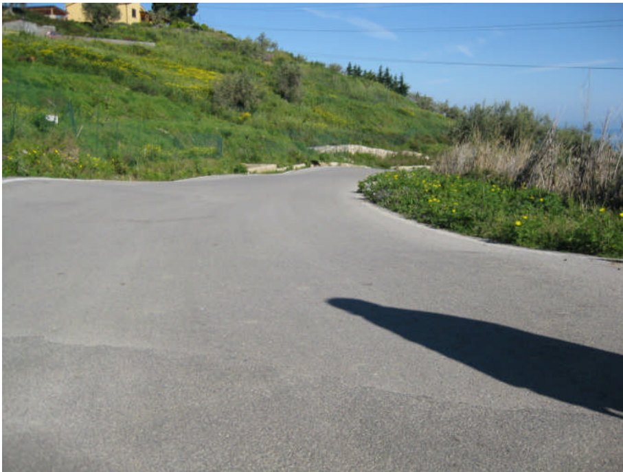
Fig. 1 – Avvallamenti e sprofondamenti in corrispondenza della strada provinciale SP 121
