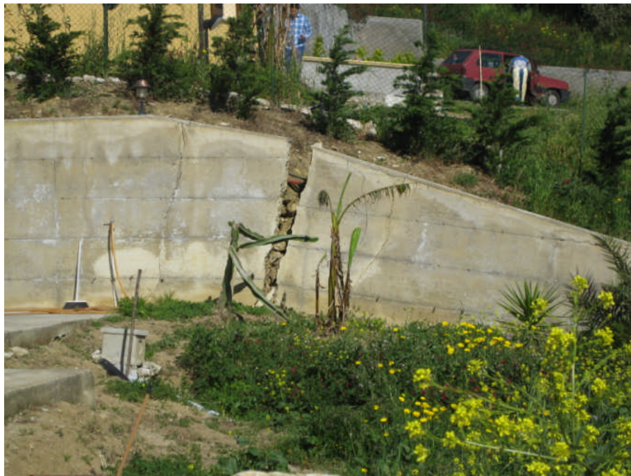
Fig. 3 – Particolare della lesione beam del muro di sostegno perimetrale fra le proprietà
