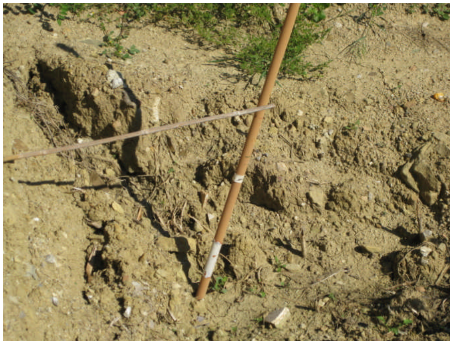
Fig. 5 – Particolare della lesione dicoronamento della frana che interessa un fabbricato
