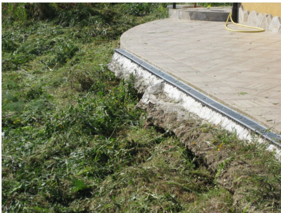
Fig. 4 – Particolare dell'area di coronamento della frana che interessa un edificio privato
