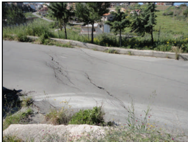
Foto 10 - Veduta della sede viaria interessata da lesioni trasversali
