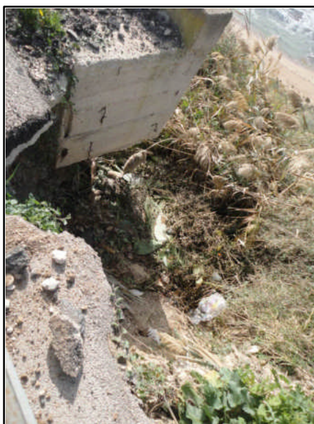
Foto 4 – Fenomeni di scalzamento nei muri (SP 68)
