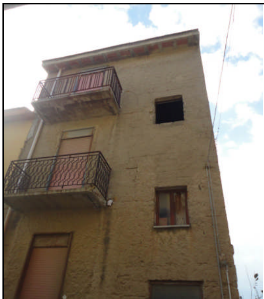
Foto 12 - Veduta dell'edificio fessurato lungo la via Palermo
