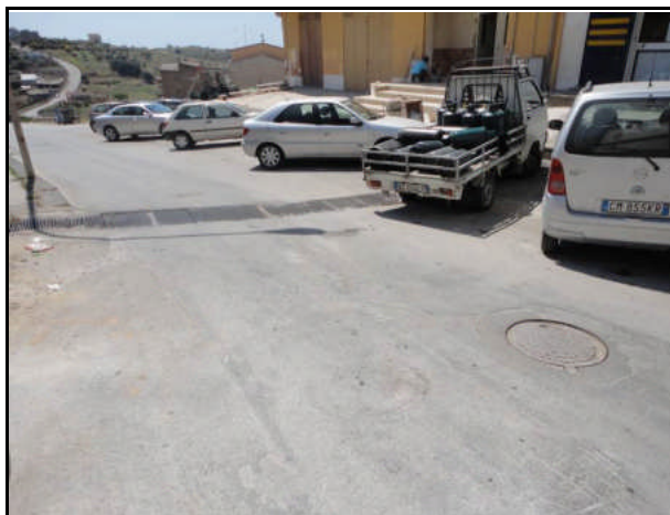
Foto 7 – Vista dello stato di dissesto della sede di Largo Parpaglione
