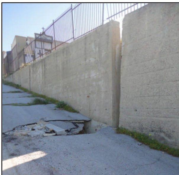
Foto 11 - Veduta della sede viaria e del muro di sostegno lesionati
