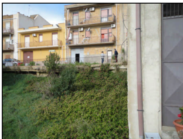
Foto 16 - Il dilavamento sotto la sede stradale deformata
