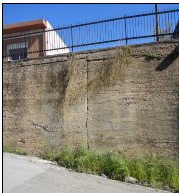
Foto 8 – Lesione del muro di sostegno cortile della Guardia Medica
