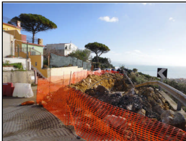
Foto 2 – Veduta della nicchia di frana
