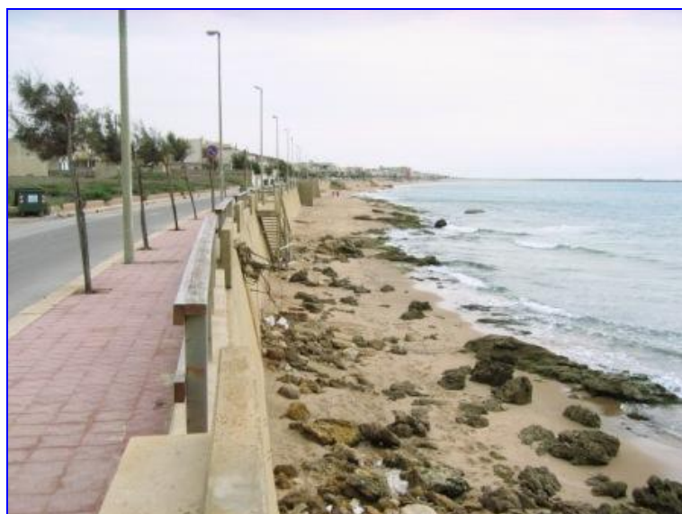
Foto 2.8 – Spiaggia in erosione, lungomare di Scoglitti (Vittoria)
